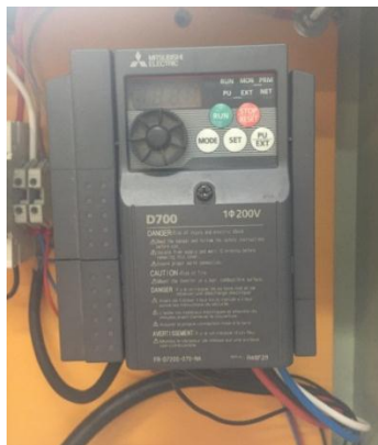
Figura 4.8: Variador de frecuencia.
