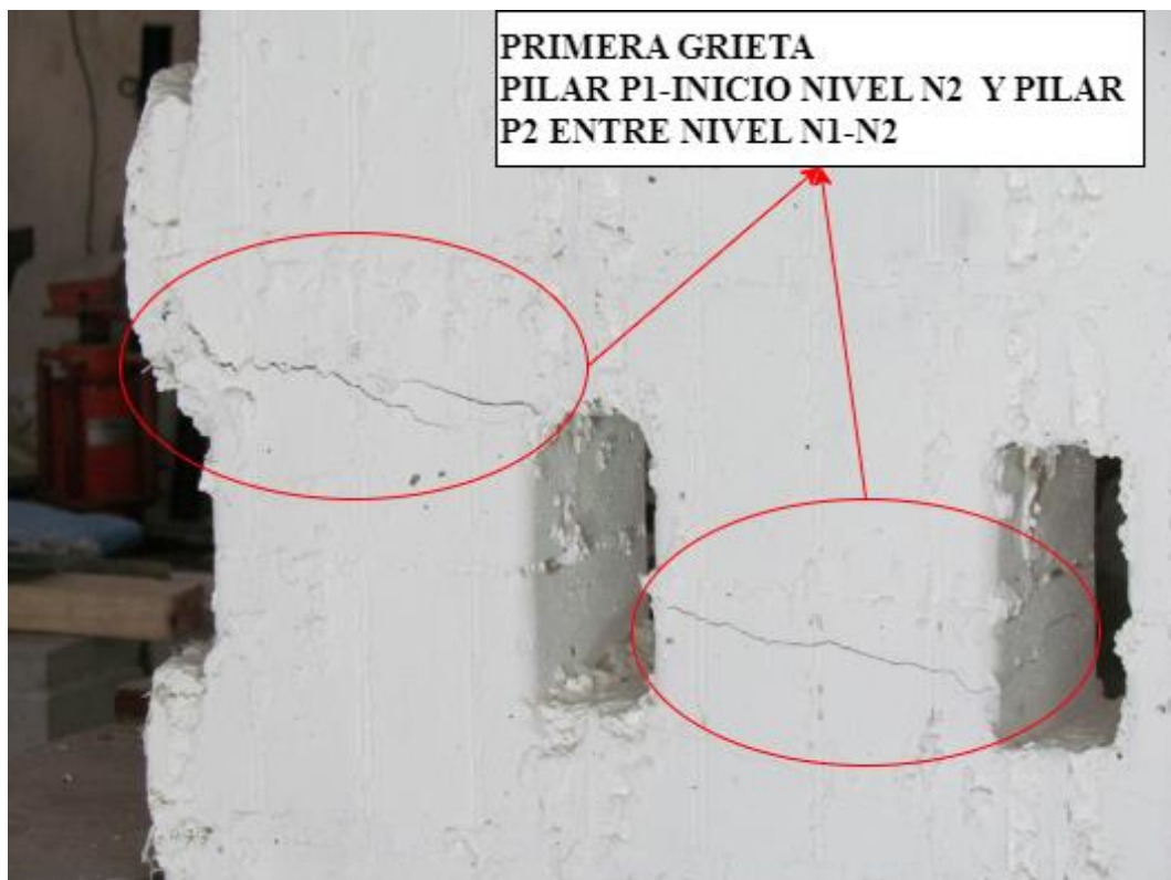
Figura 4.31. Distorsión angular 0.15% primera grieta FC1-S3
