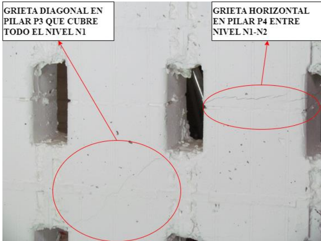
Figura 4.39. Distorsión angular 0.12% primer agrietamiento importante sentido positivo FC2-S3
