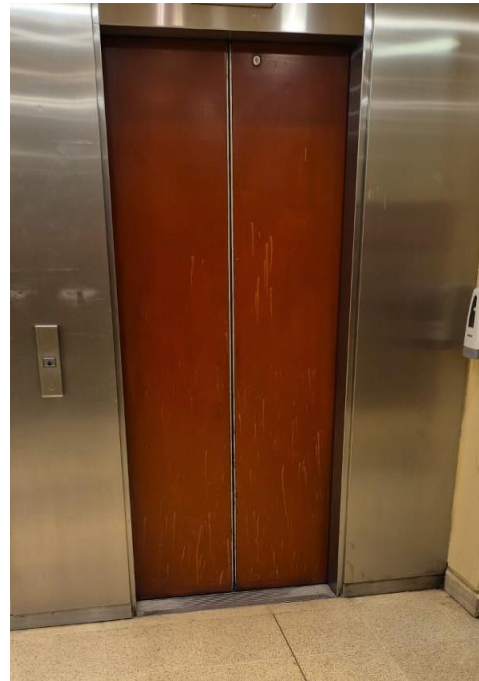
Figura 2.2: Puerta de ascensores
