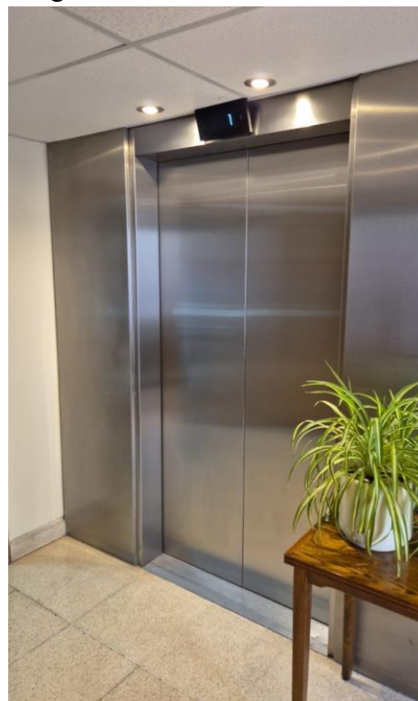
Figura 2.7: Puerta de ascensores
