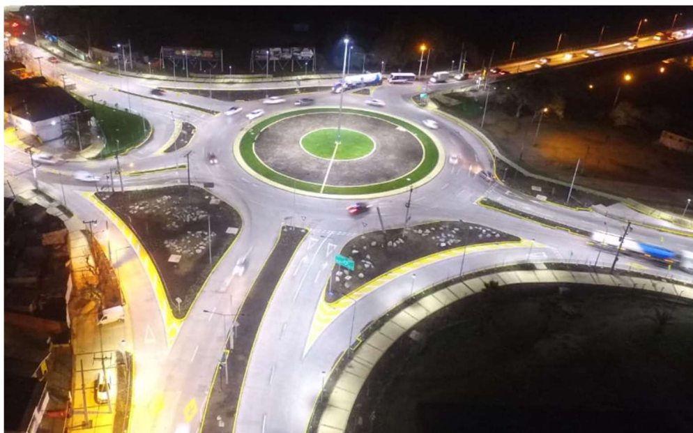
Figura 1-5 Sistema Actual de Iluminación de la Rotonda de Concón
