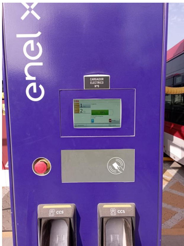
Figura 14: Zoom al cargador, donde se observa un tipo de conector CCS y carga del 79%, entregando 180 kW [foto propia].
