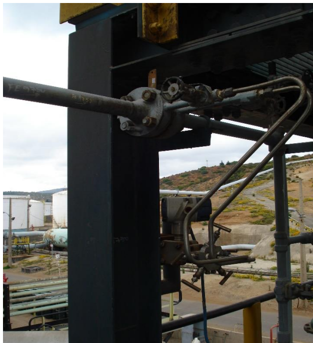
Figura 18: Placa orificio junto a transmisor Fuente: Elaboración propia
