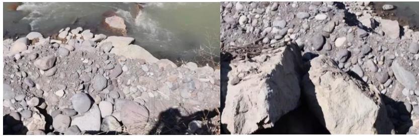
Figura 18. Deterioro Espigón río Tinguiririca sector Pedehue.
