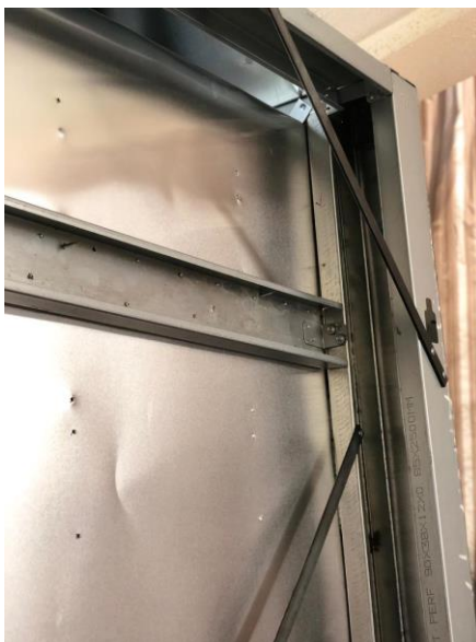
Figura 55: Imagen de tensores de acero.
