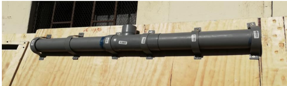
Figura 33: Canalizador de flujo para radiador de aire fabricado mediante tuberías de PVC.
