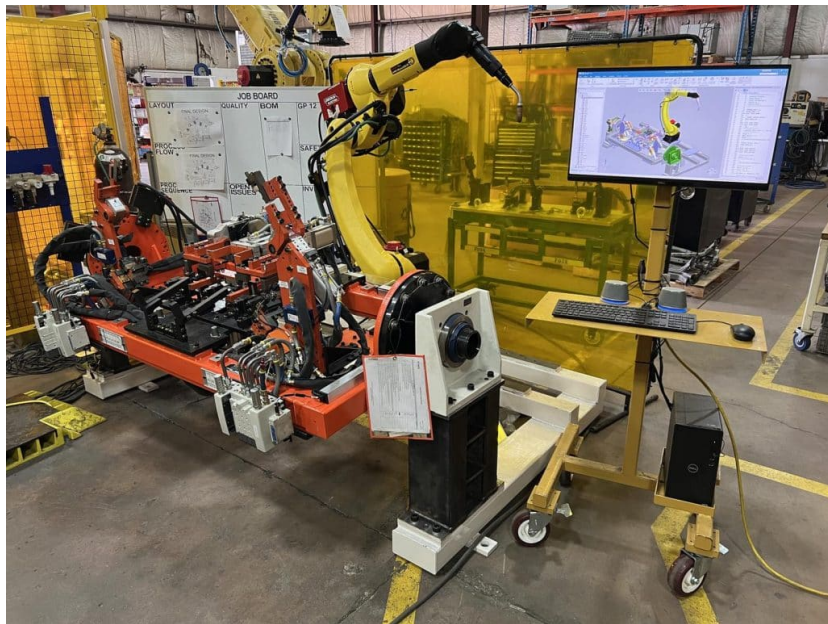
Figura 1.3: Sistema Automático de Soldadura
