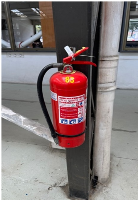
Figura 3.7: Extintor del Área
