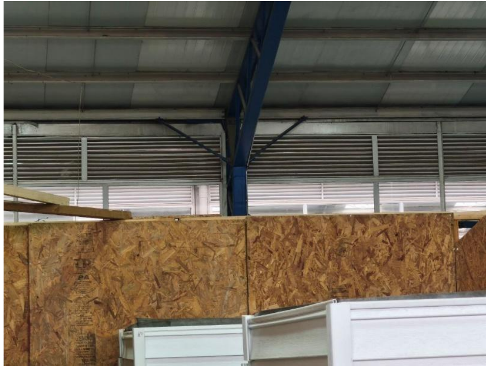
Figura 1-7. Celosías de aluminio abiertas asociadas a infiltración permanente.
