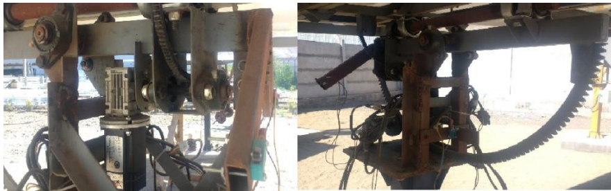
Figura 70: Daños de corrosión y fatiga estructural de heliostatos, equipo indisponible.
