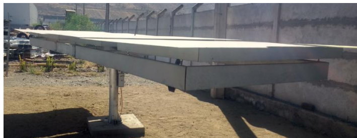
Figura 71: Heliostato con cuatro espejos reflectantes con fenómeno de pandeo.
