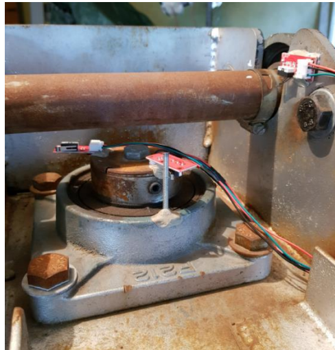
Figura 114: Dispositivos de final de carrera instalados.
