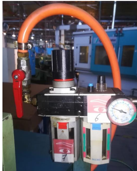
Imagen 14: Unidad de mantenimiento neumático
