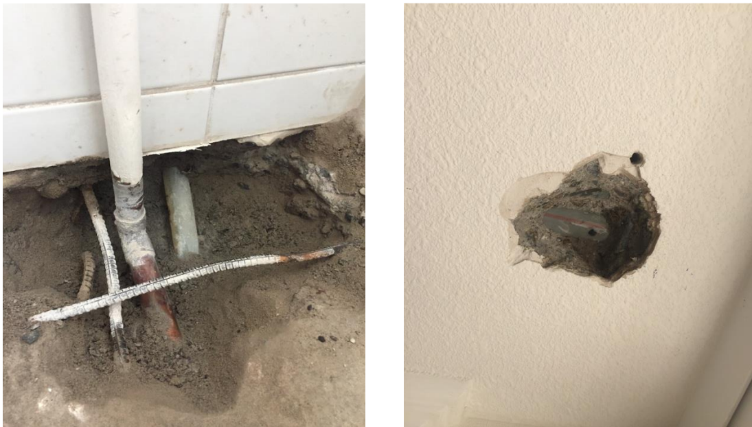
Dentro de los trabajos más comunes a los cuales toca enfrentarse son los pinchazos en cañerías, en este caso de cobre y en la otra imagen una negligencia que fue la perforación de una cañería de agua.
