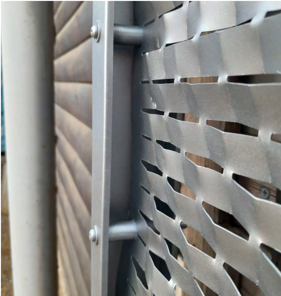
Fig. 81. Fotografía detalle de fijación prototipo 1 Fuente: Elaboración propia (2026)
