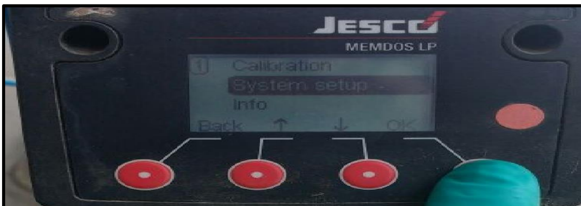
Ilustración 5.94 Navegación menú bomba dosificadora.
