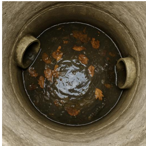
Figura 4-7. Ejemplo de cámara de inspección con presencia de residuos. Fuente: Elaboración propia (IA).
