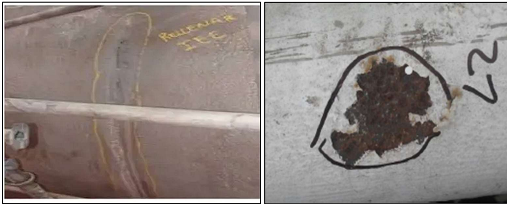
Figura A1. 3. Pérdida localizada de metal (zonas demarcadas y definidas)
