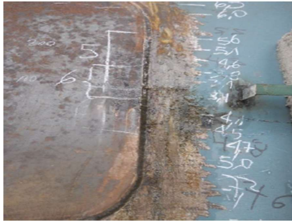
Figura 2. Zona de corrosión adyacente al parche de refuerzo.
