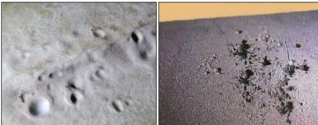
Figura A1. 4. Daño por picaduras: base interior de tanque atmosférico/ superficie de tubería)
