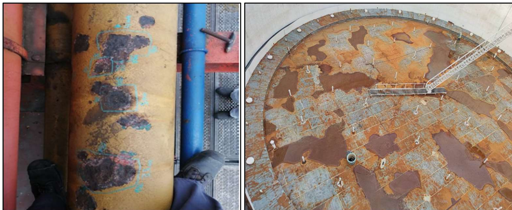
Figura A1. 2. Pérdida generalizada de metal (zonas indefinidas de tamaño variable y áreas extensas)
