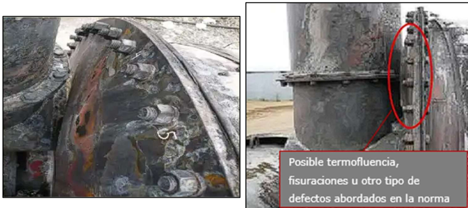
Figura A1. 9. Daños por incendio Fuente: Evaluación parte 11 API 579-1/ASME FFS-1
