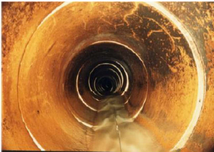
A-3 Grieta Múltiple
