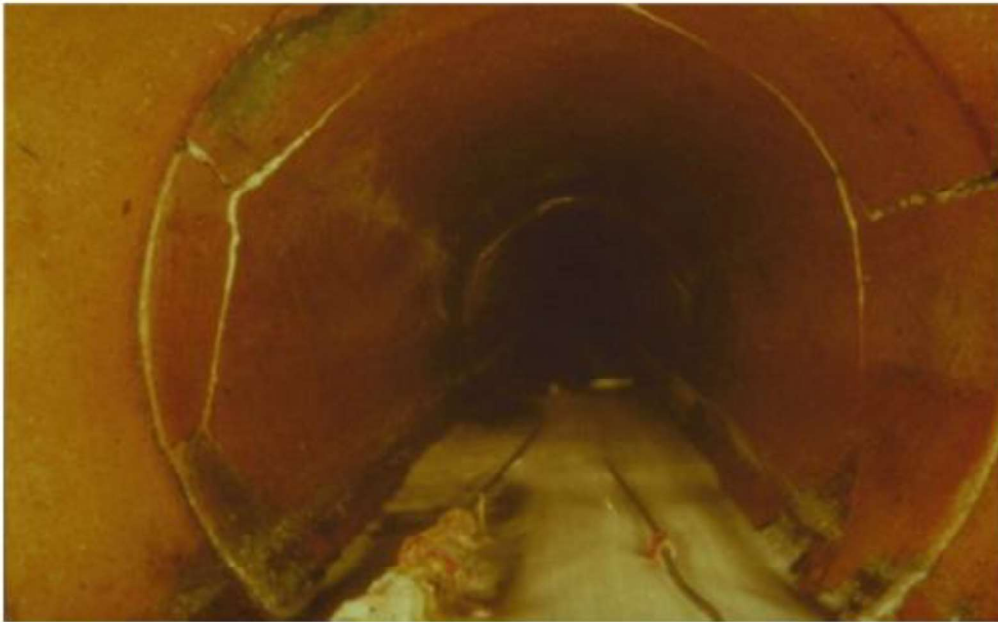
A-4 Grieta en Espiral (CS)
