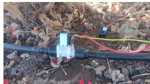
Figura 3.23: Electrovalvula y sensor de humedad capacitivo
