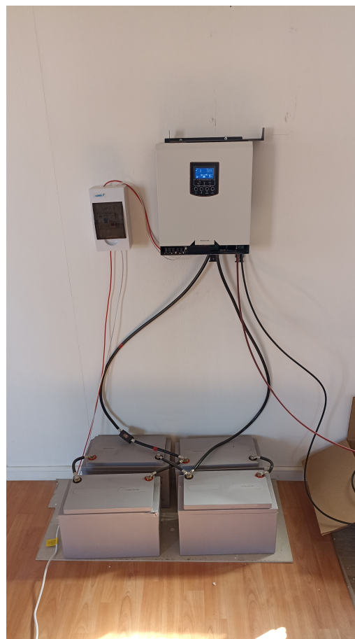
Figura 3.19: Inversor y banco de baterías instalados
