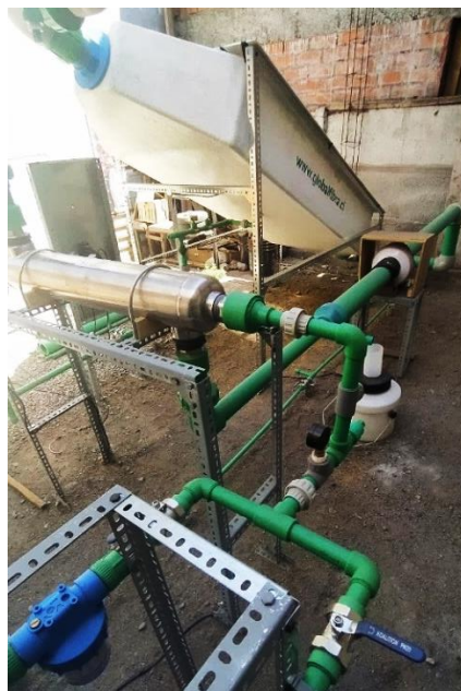
Figura 4- 13. Conexión entre la unidad de filtrado y el deshumificador.
