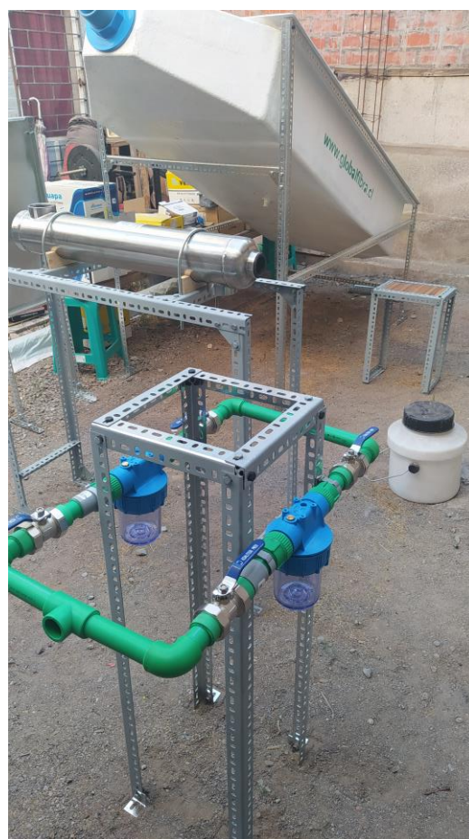
Figura 4- 8. Vista trasera de la ubicación de los equipos.
