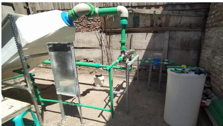
Figura 4- 10. Conexión de las tuberías de PPR utilizadas para conectar los equipo.
