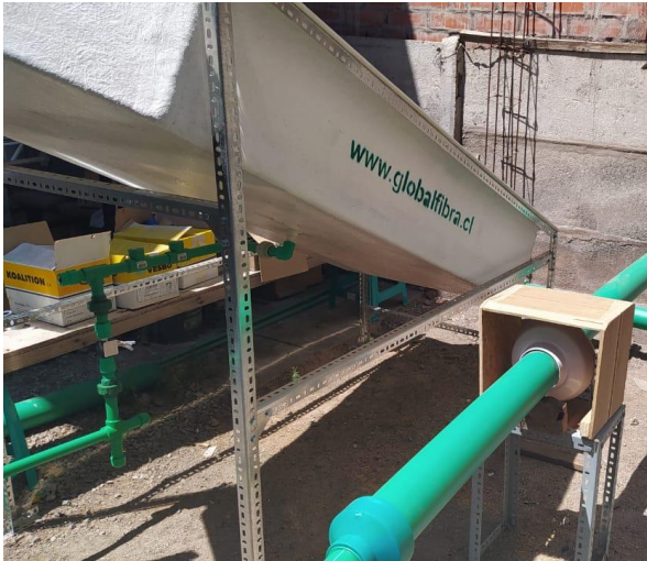
Figura 4- 11. Conexiones de PPR entre el extractor y el deshumificador.
