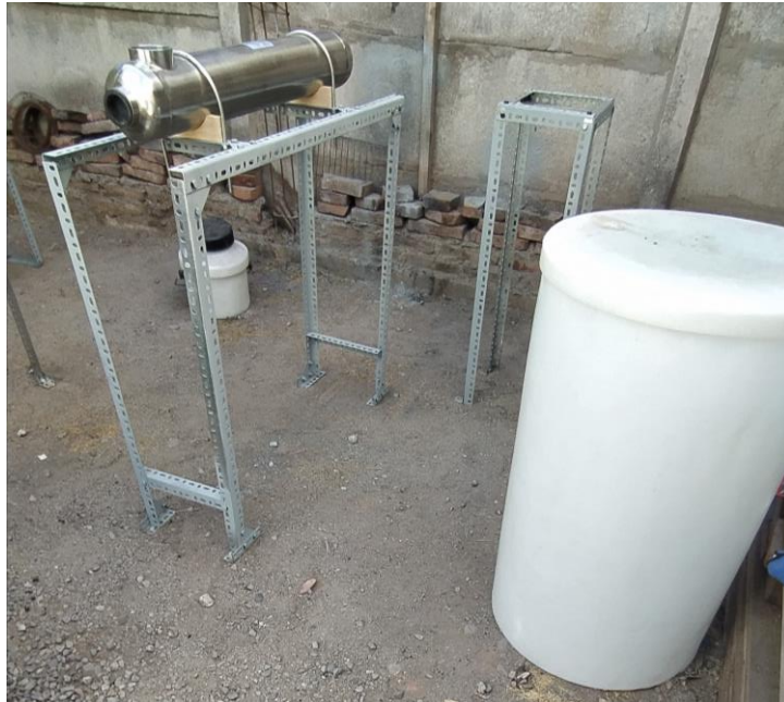
Figura 4- 5. Deshumificador instalado en su respectiva estructura, junto el estanque del agua salada y la estructura de la unidad de filtrado.
