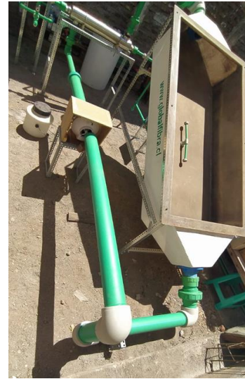
Figura 4- 12- Vista frontal de las conexiones en PPR entre el extractor y el humidificador.
