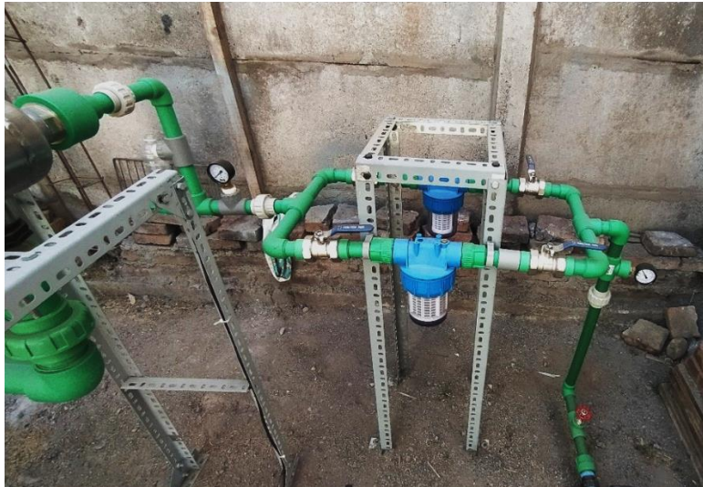
Figura 4- 19. Manómetros a la entrada y salida de la unidad de filtrado.
