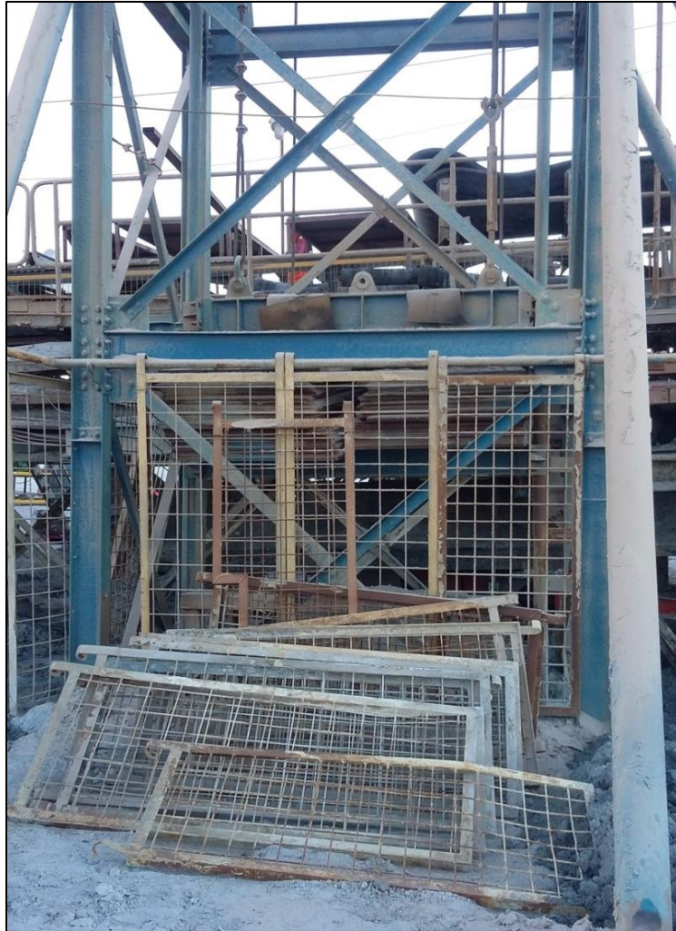
Figura 2-17. Sistema de contrapeso CV-114.
