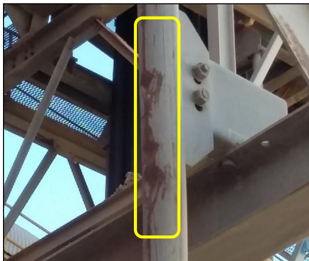
Figura 2-5. Abolladura viga tubular del contrapeso CV-111.
