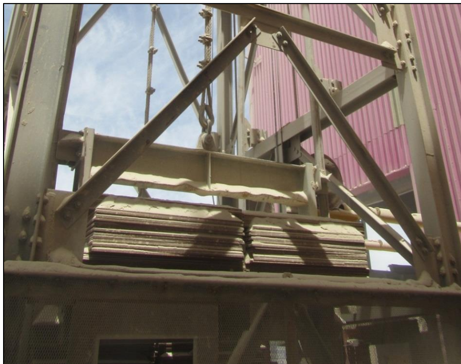
Figura 2-1. Sistema de contrapeso CV-110
