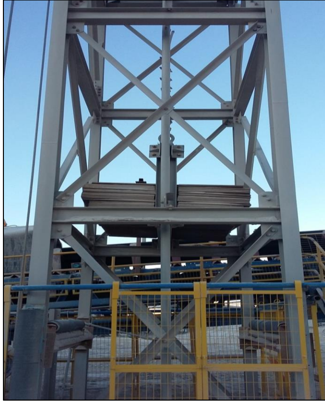
Figura 2-8. Sistema de contrapeso CV-112.
