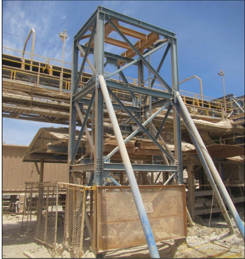
Figura 2-11. Sistema de contrapeso CV-113.
