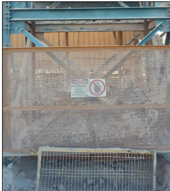
Figura 2-12. Protección metálica del contrapeso CV-113.
