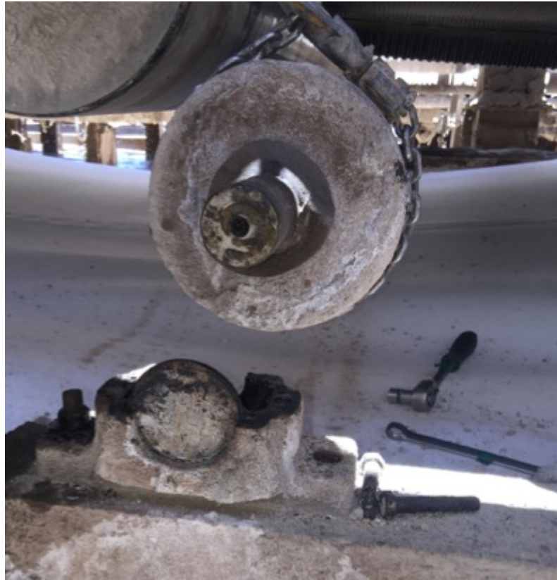
Figura 2.59 Eje del rodillo tras desmontaje del rodamiento dañado.
