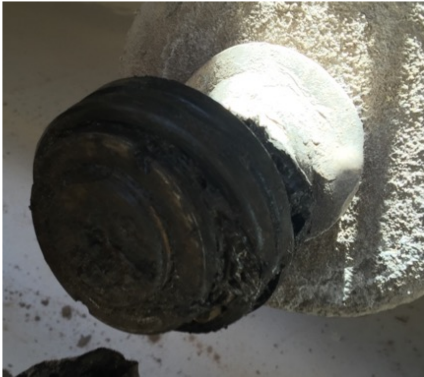
Figura 2.12 Rodamiento cubierto con grasa descompuesta.
