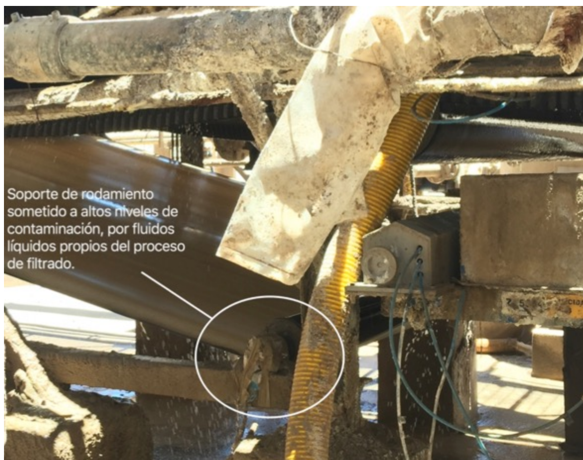
Figura 2.7 Zona inferior del filtro, donde se ubica un rodamiento.
