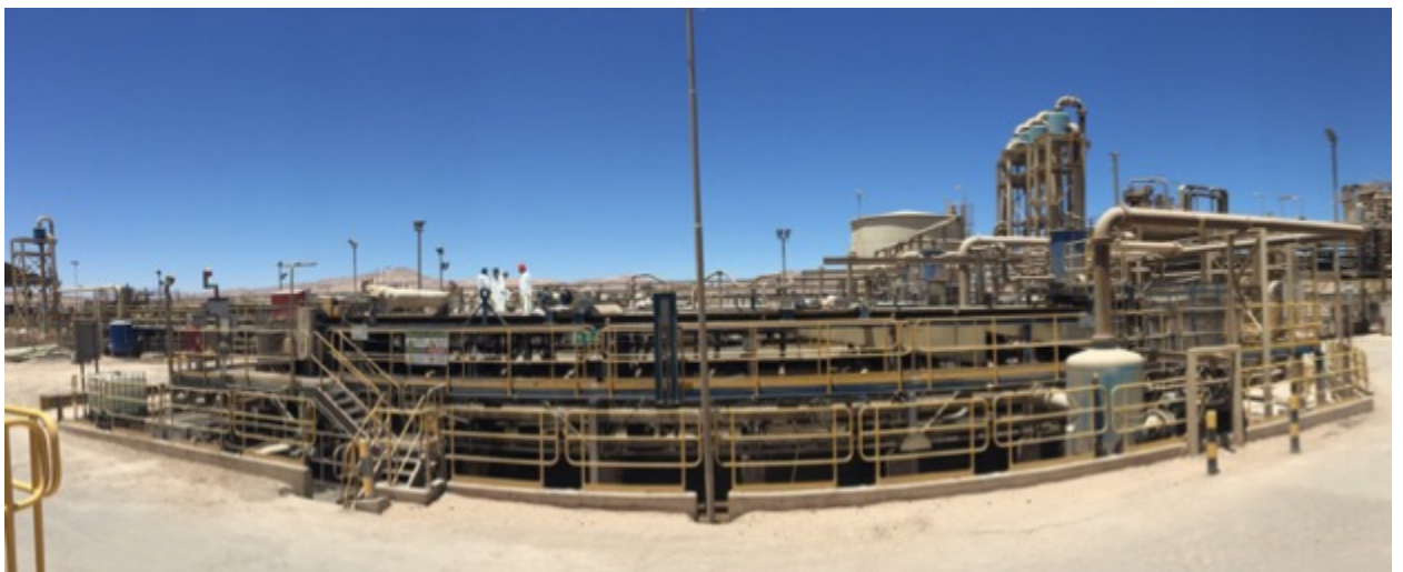
Figura 2.2 Vista panorámica sector filtros de banda.
