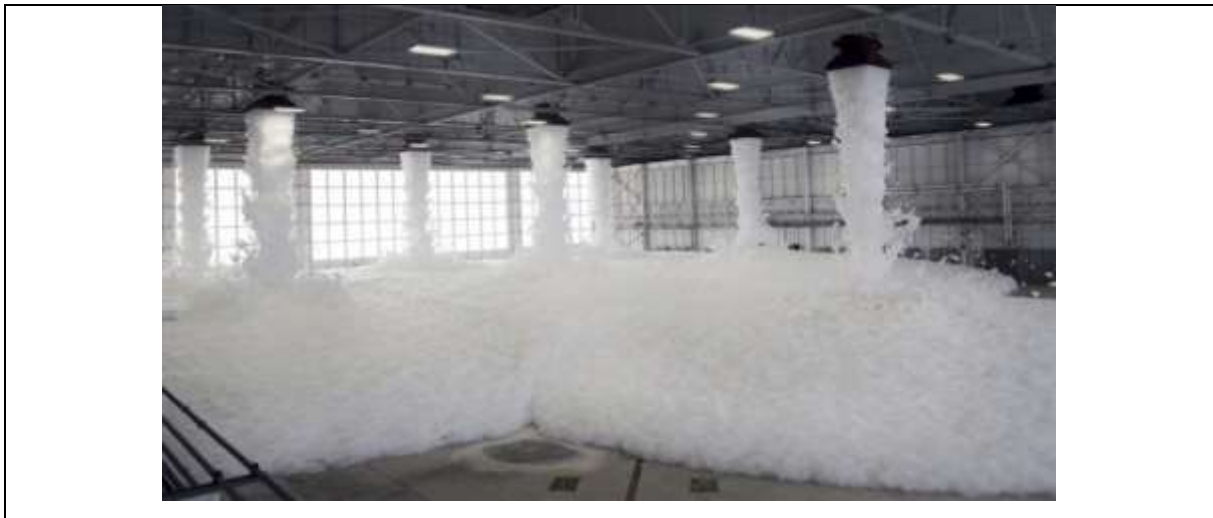
Figura 4-4: Inundación total interior por espuma de alta expansión
