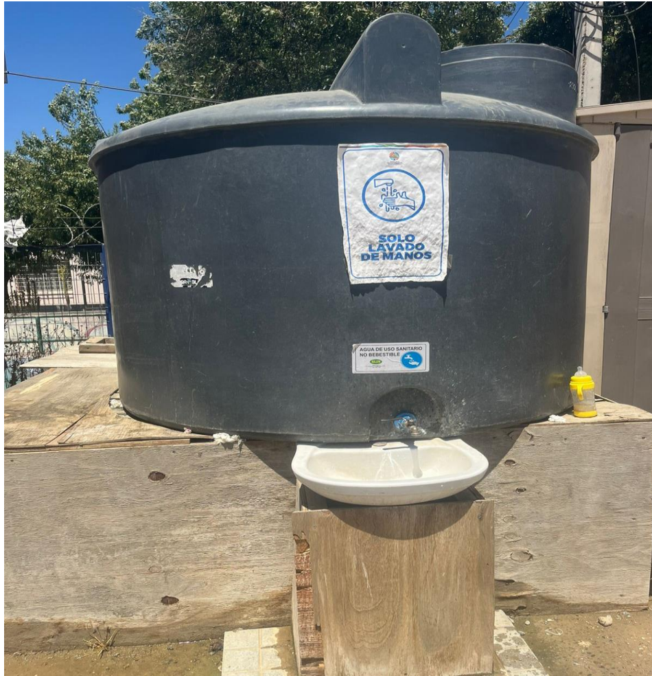
Figura 3-2. Estanque de agua en el recinto.
