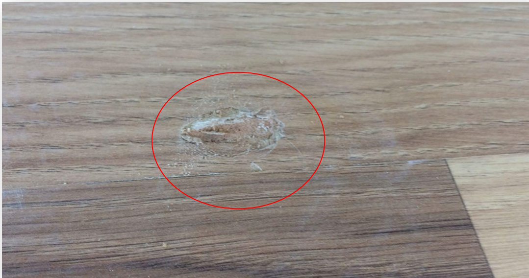
Fuente: Registro Viconsá Limitada. Figura 2-12 Piso Flotante picado
