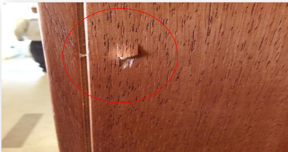
Fuente: Registro Viconsá Limitada. Figura 2-20 piquetes en puerta.
