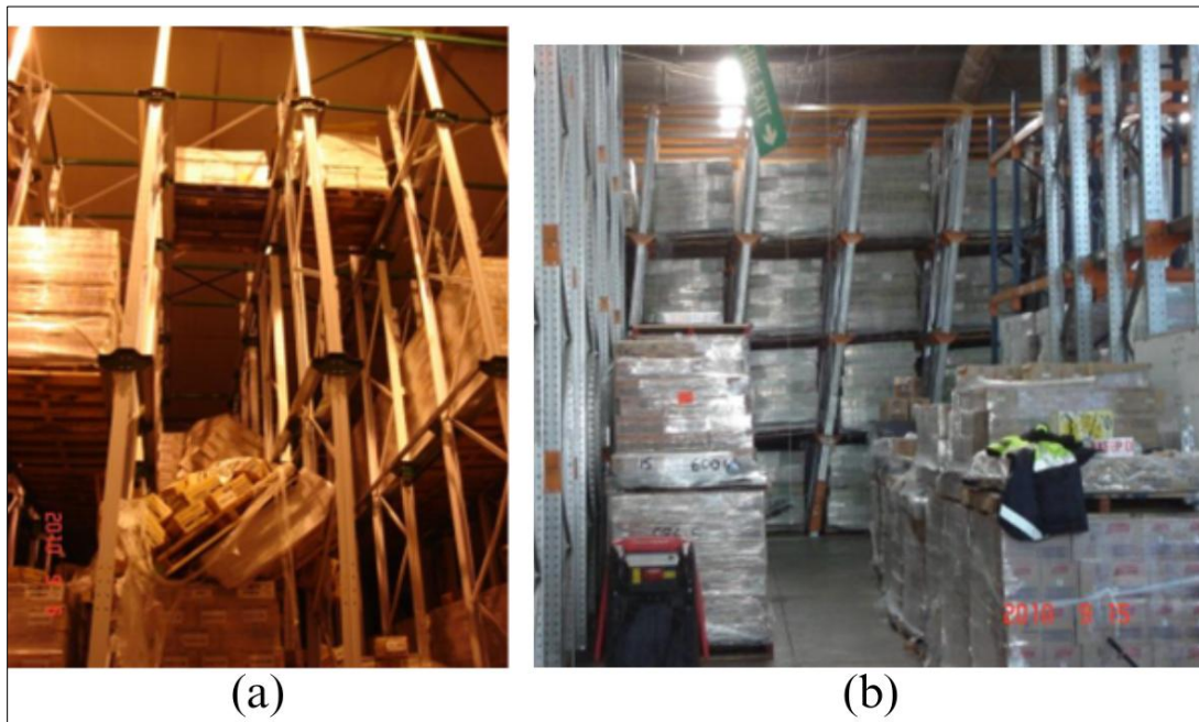
Figura 2-7: Daños de racks “drive-in” reportados en Terremoto de Darfield 2010; (a) caída de palés entre vigas riel (b) falla lateral generalizada
