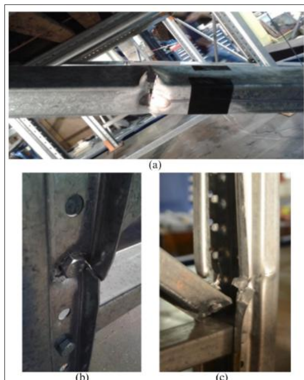
Figura 2-14: Fallas principales evidenciadas por Shaheen y Rasmussen (2019) en sistema de marcos transversales completamente arriostrados; (a)Pandeo riostra diagonal inferior (b) daño en la conexión columna-riostra (c) desprendimiento de riostra de la columna
