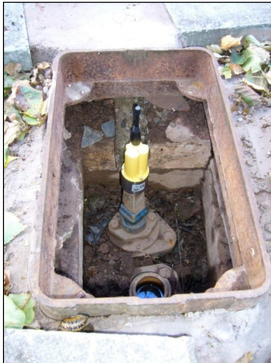
Figura 3. 11 Ejemplo de instalación de permalogs (Elaboración propia)
