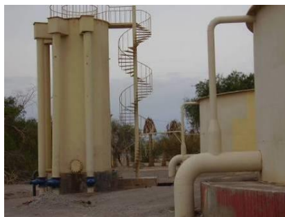
Figura 3. 3 Torre de aireación Canchones para reducir Mn (ADA)
