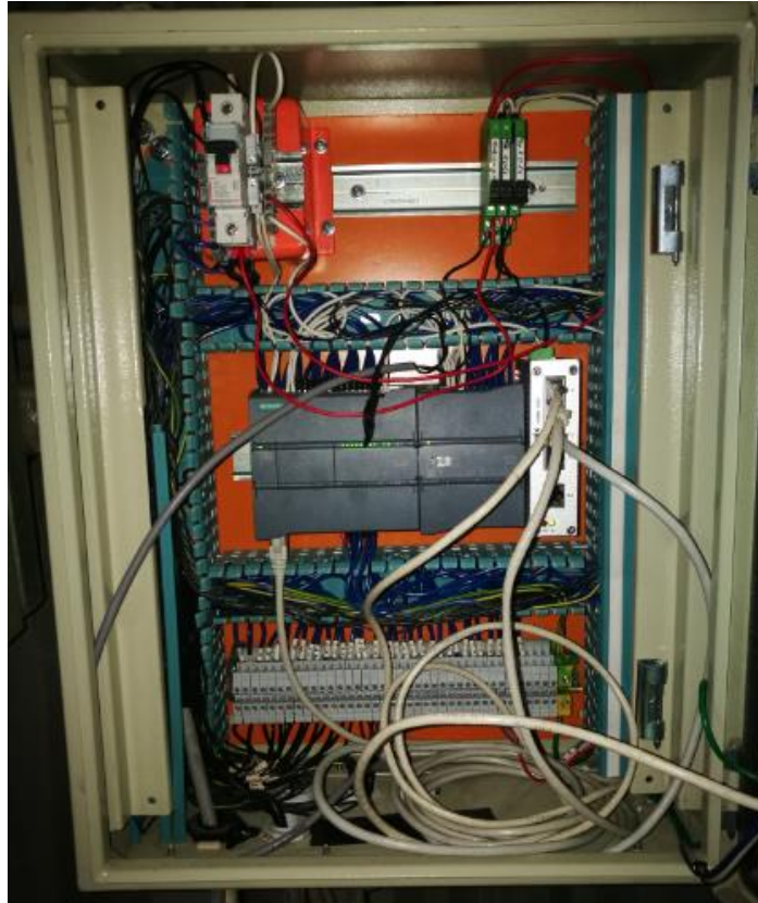
Montaje y configuración de equipos PLC Alarmas.
