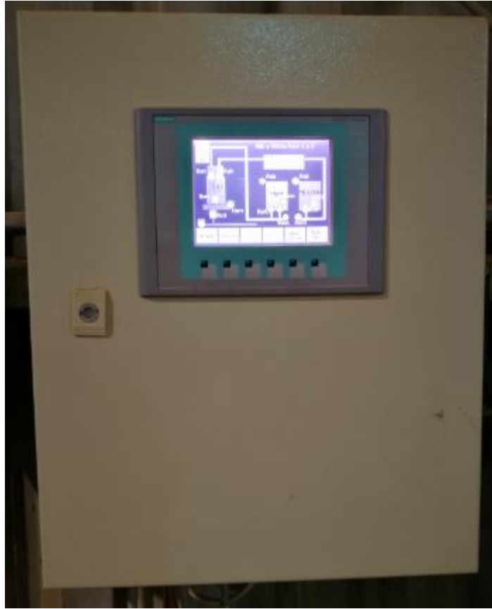
Vista HMI, PLC Alarmas.
