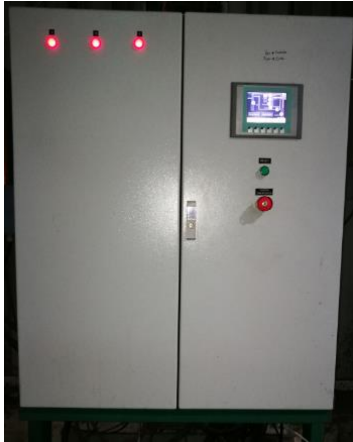
Vista exterior tablero control Sistema Aspiración, HMI.
