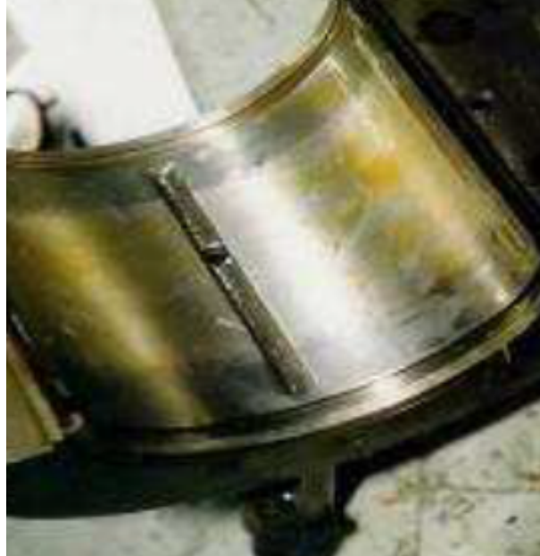
Figura 19: Película lubricante en buje de apoyo de turbina a vapor cuyo eje gira a 3600 [rpm].
