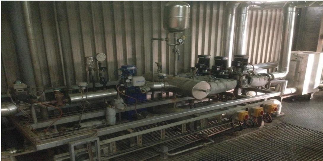
Figura 1 – 6 Válvula de adición Fuente: Elaboración propia
