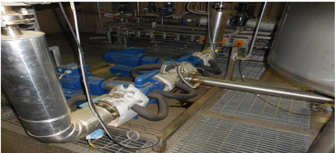
Figura 1 – 5 Bombas de adición
