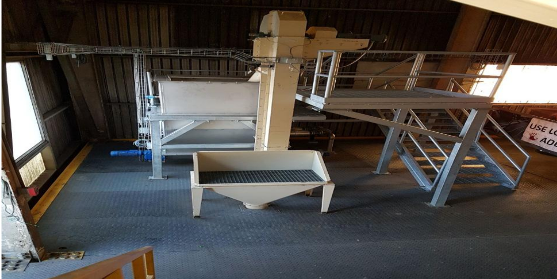
Figura 1 – 2 Tolva adición Fuente: Elaboración propia
