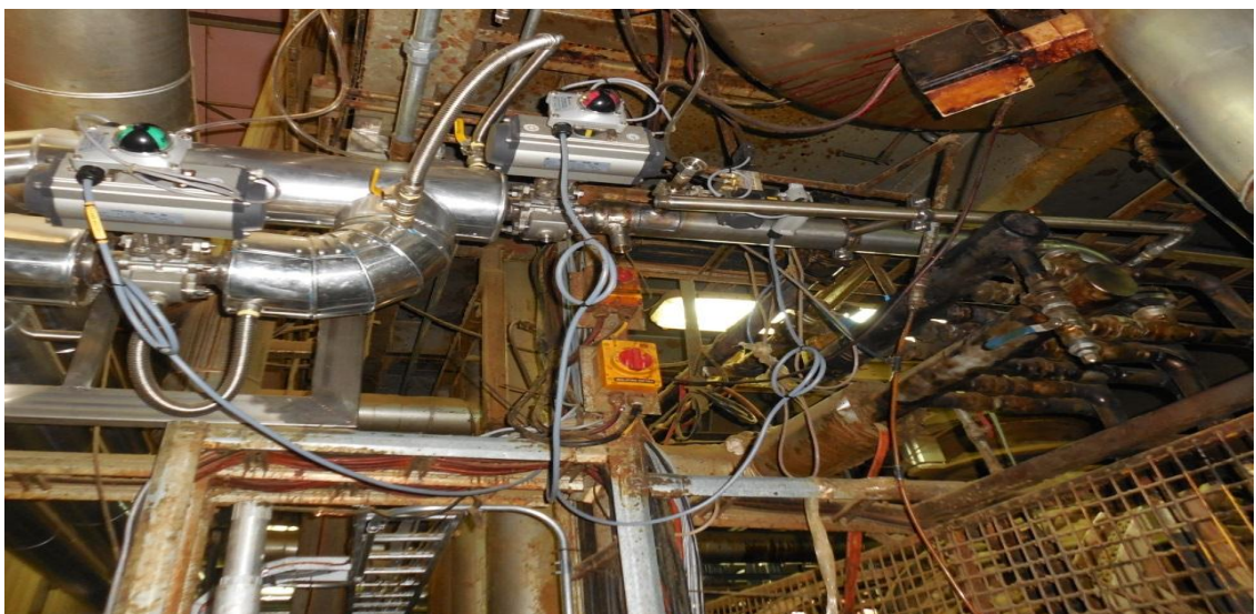
Figura 1 – 7 Válvula recirculación Fuente: Elaboración propia
