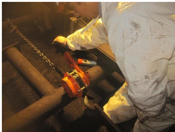
Figura 2 – 1: Movimientos repetitivos en Mantenimiento de precipitador electrostático
