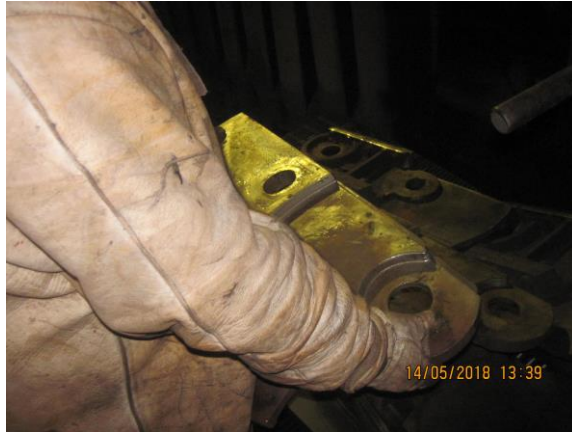
Figura 2 – 3: Uso de Fuerza en retiro de Placas Laterales de Horno Parrilla
