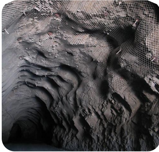
Figura 3-10. Referencia malla de fortificación
