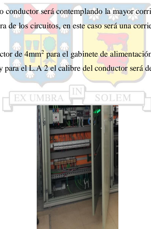
Imagen 5 Barra repartidora de tierra
