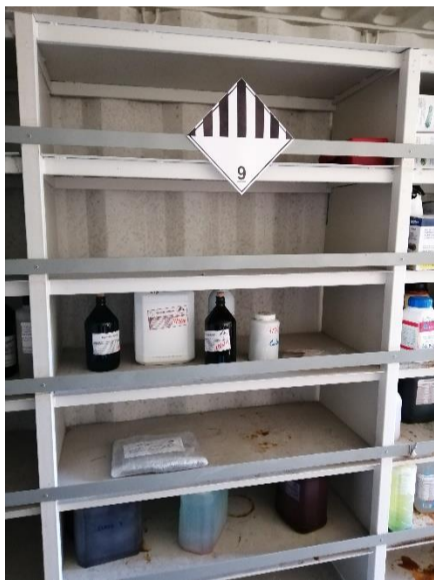
(5.15) Bodega de almacenamiento de residuos peligrosos, sustancias y objetos peligrosos variados.
