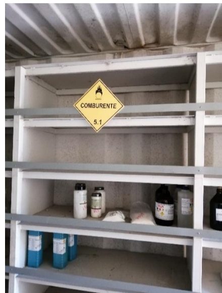
(5.16) Bodega de almacenamiento de residuos peligrosos, sustancias comburentes.
