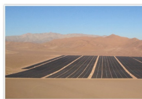
Planta Fotovoltaica Amanecer Solar (Copiapó)
