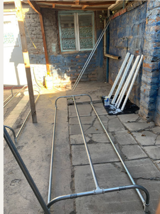
Secado de pintura y otros materiales
