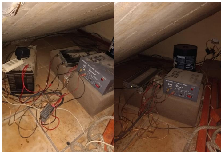
Figura 6-3. Sistema de respaldo utilizado, UPS. Fuente: Fotografía tomada en visita de terreno; Agradecimientos al personal de la 5ta compañía por permitir la visita de terreno y toma de fotos.
