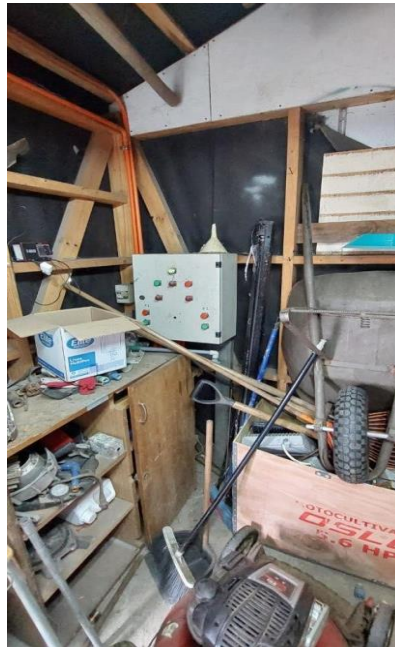
Ilustración 6: tablero electro funcionamiento de las bombas fuente: elaboración propia
