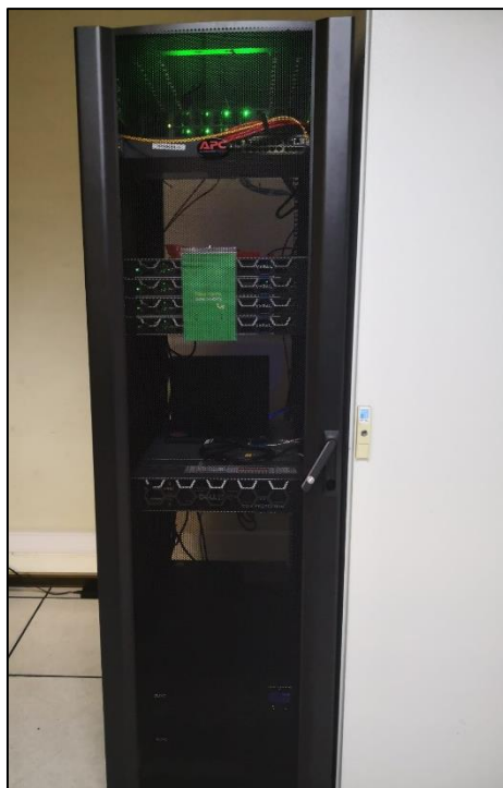
Figura 10-56: VxRail en sitio.
