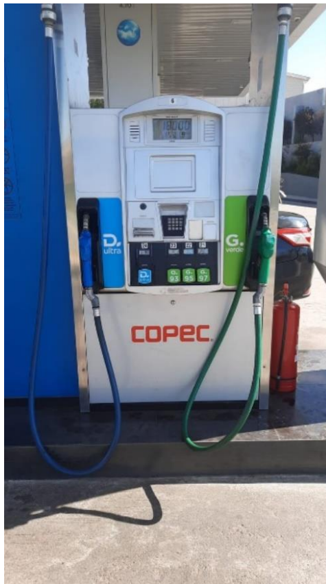
Figura 1-16: Surtidor estación SEYTO
