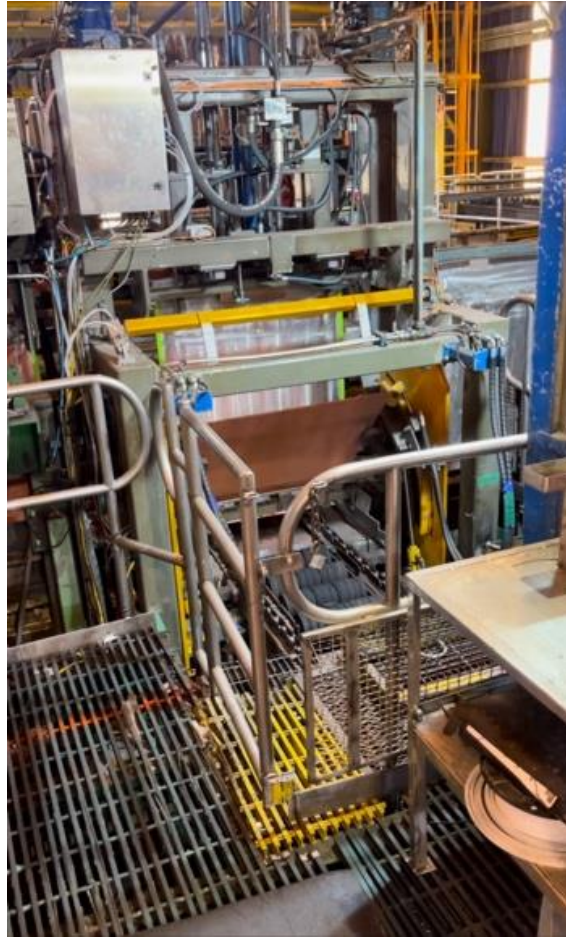
Fig.13: Estación de Despegue (unidad de cuchillos) Máquina Despegadora de Cátodos.
