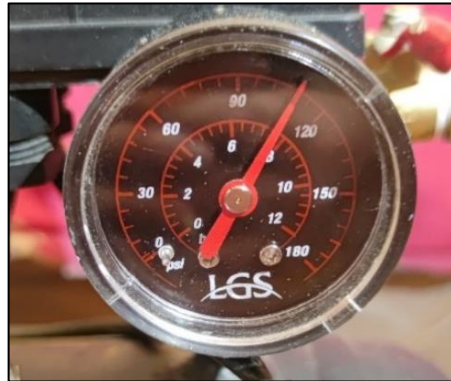
Figura 39. Manómetro del compresor cargado.
