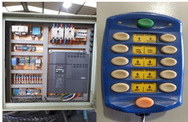
Figura 2-3 Tablero de mando y control remoto
