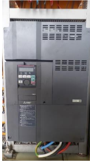
Figura 2-9 Variador de frecuencia de bomba tipo draga
