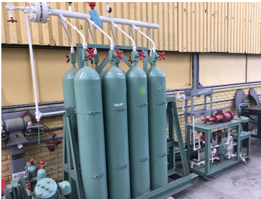
Figure 7 acumulador de aire para pruebas de psv.
