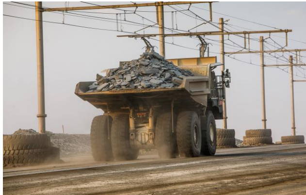
Figura 11. Sistema de catenarias ubicado en la subida de una rampa de acceso.
