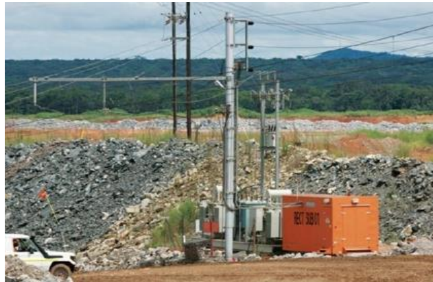
Figura 12. Subestación de tracción a un costado de la rampa de acceso.
