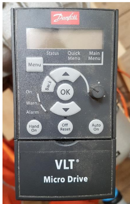
Figura 31: Variador de frecuencia conectado al motor soplador.
