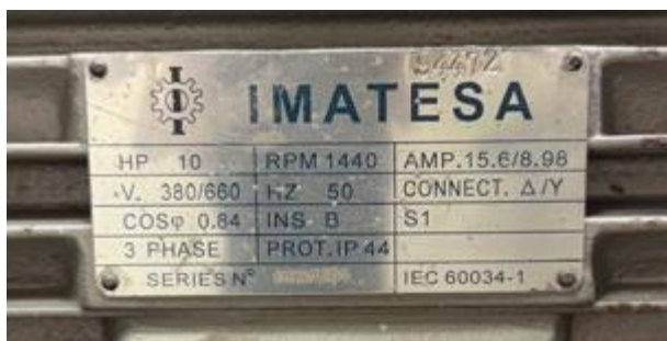
Figura 2-3 Fotografía de placa de motor chancador primario Salas.
