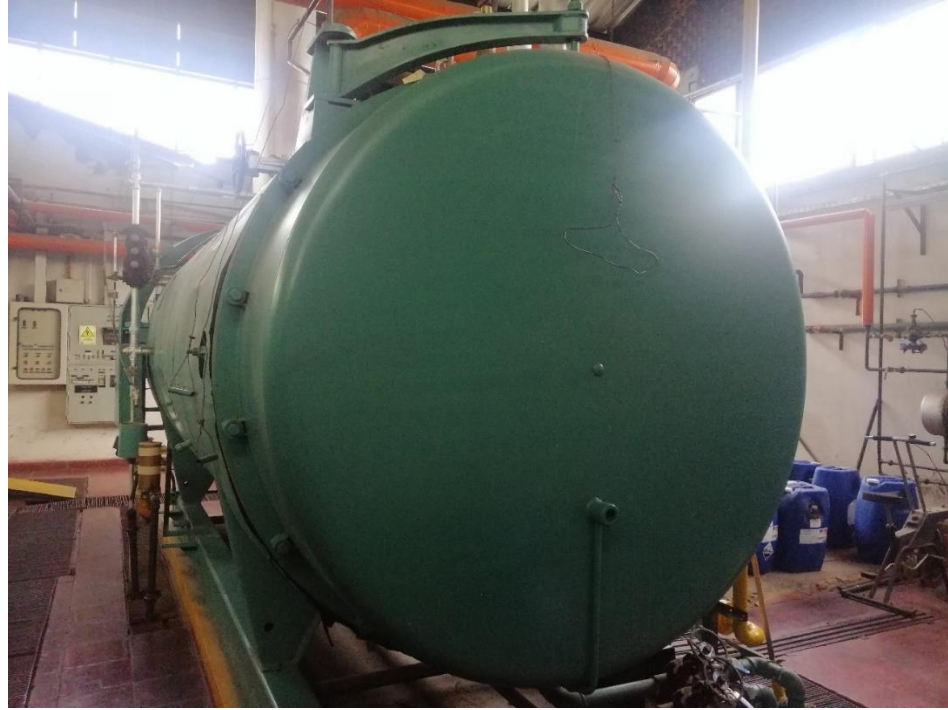
Figura 3-15: Zona posterior de la Caldera de Vapor Cleaver Brooks
