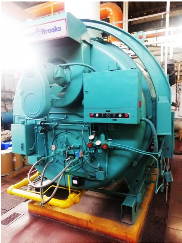
Figura 3-12: Sistema de Control, Encendido, y Funcionamiento Automático de la Caldera
