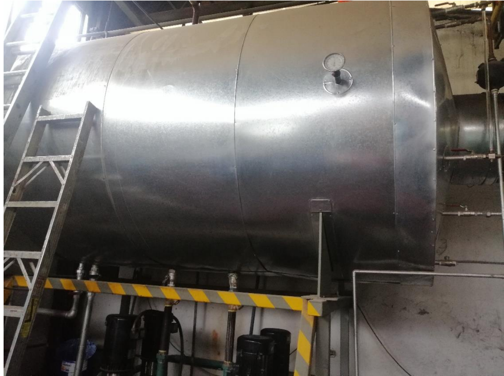
Figura 3-19: Estanque de Alimentación Principal de la Central Térmica
