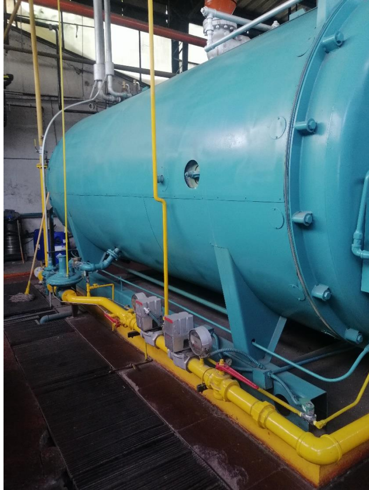
Figura 3-18: Línea de Alimentación de Gas y Línea de Purga de la Caldera – Vista Frontal
