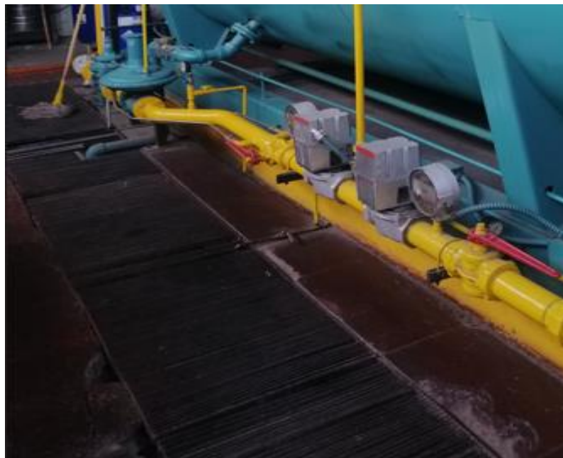
Figura 2-15: Rejillas de protección y tránsito de las líneas de alimentación y purga de agua de la central térmica
