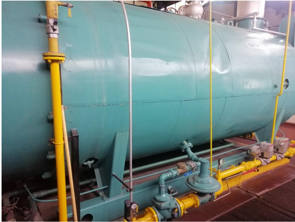
Figura 3-16: Línea de Alimentación de Gas y Línea de Purga de la Caldera – Zona Posterior
