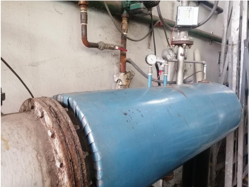
Figura 3-21: Caldera de Uso Civil de la Central Térmica
