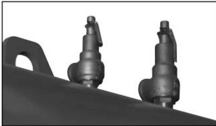
Figura 2-10: Válvulas de alivio de presión de la caldera
