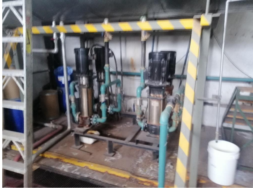
Figura 3-20: Estanque de Alimentación Principal de la Central Térmica
