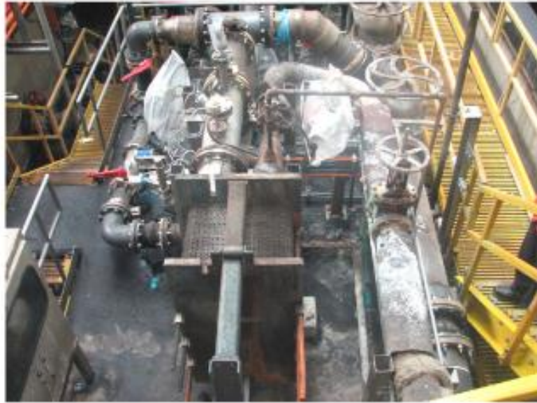
Figura 8.1.2 Vista General del intercambiador de calor
