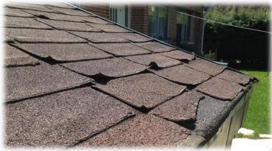
(Figura 5.1 Teja Asfáltica con daños por efectos del clima.)
