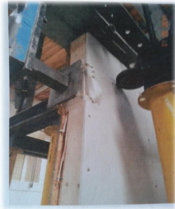
(Figura 4.2 Modos de falla observados en paneles.)
