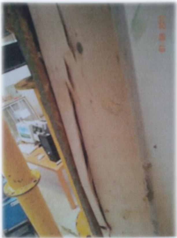
(Figura 4.3 Modos de falla observados en paneles.)
