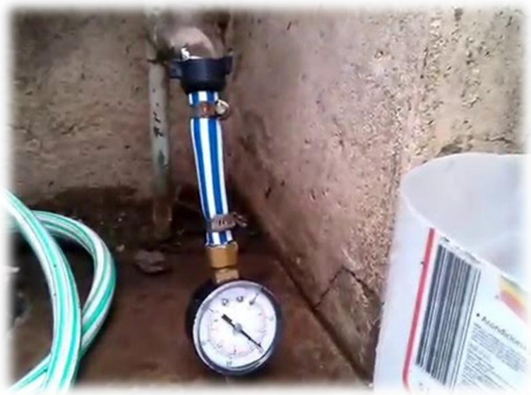
(Imagen 5.2: Medición de presión de agua potable con un manómetro.)
